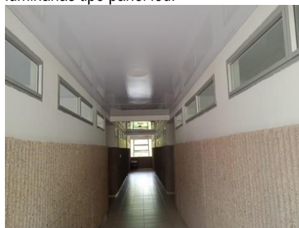
Fotografía 22. Obras terminadas en bloque 1, se evidencia cielo raso en PVC, ventaneria, acabados en pintura y luminarias tipo panel led.
